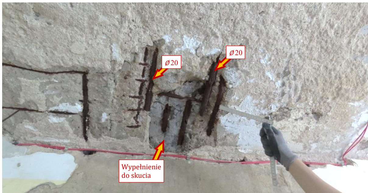
Fot. 60 Przykładowe miejsce do naprawy. Widoczne wypełnienie dawnej bruzdy materiałem o gorszych parametrach niż beton płyty kanałowej.
